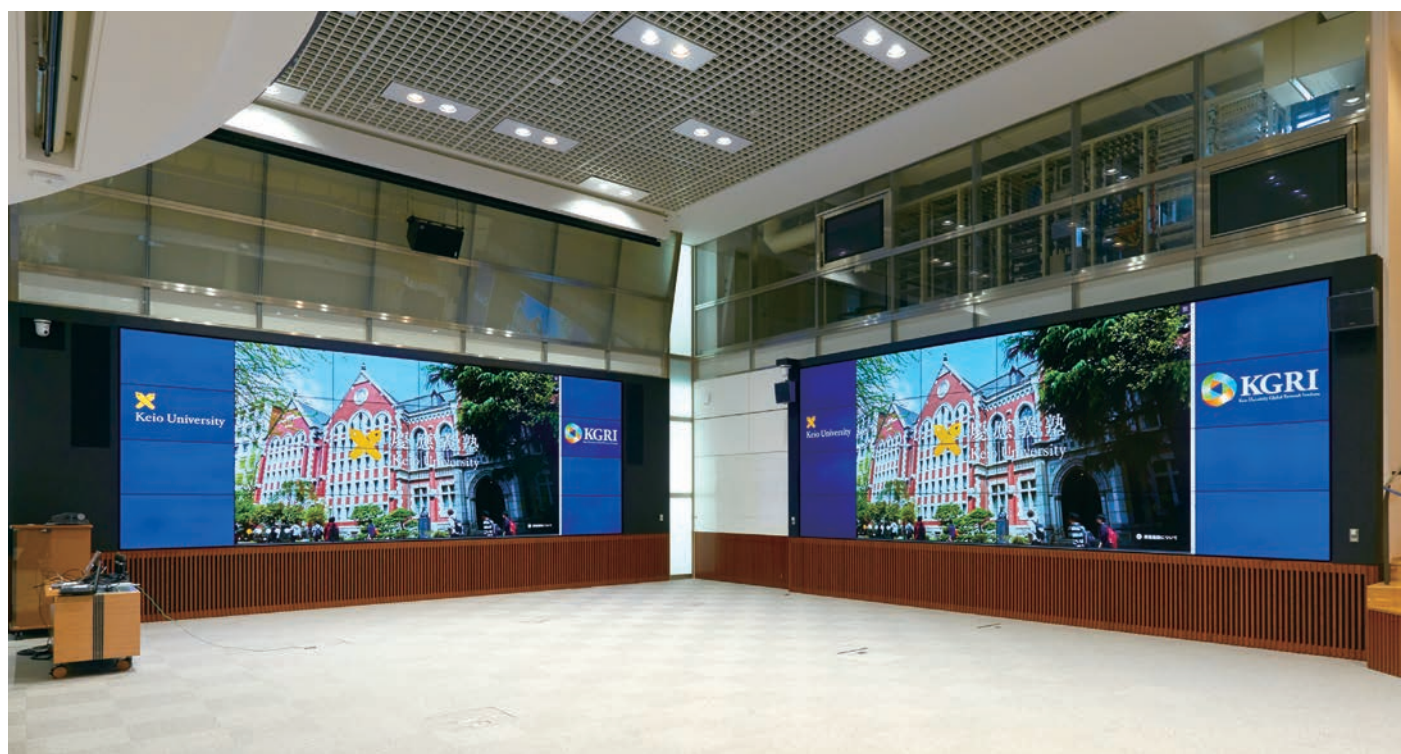
▲正面と右側面に55V型・縦4面×横6面の24面の大型マルチスクリーンシステムを2基導入。映像音響機器も大幅に刷新された
