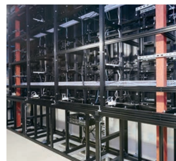
▲デジタルリンクを採用し、シンプルな配線でマルチスクリーンシステムを構築。省スペース化によって、バックヤードのスペースを活用されていた
