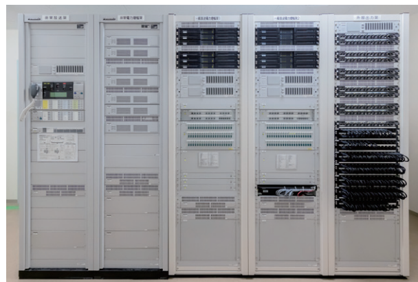
▲ 放送機器室、RAMSAデジタルパワーアンプWP-DM912とラック形非常用放送設備WL-8500Aが導入された
