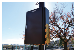
▲電源やネットワークハブなどが収納された機器収納ボックス
