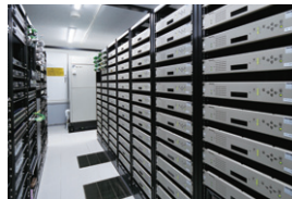
▲7台のラックに収められた合計83台のIP-MUX装置
