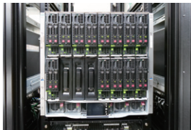
▲1台で64CHの放送が可能なIPバーチャル番組送出システムのブレードサーバー
