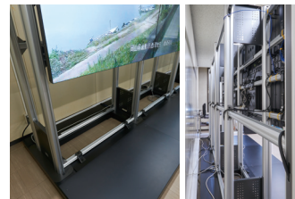
▲建築構造から壁に設置することができなかったため、パイプで躯体が作成され、耐震固定は床面へ行われた
