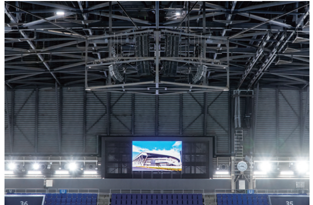
▲有明コロシアムの開閉式屋根に設置されたラインアレイスピーカー。リギングプレートにクイックリリースピンを挿すだけで簡単に固定できるため、施工時は1キャビネットずつ運び上げてからアレイを組んだ
