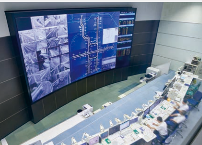
70型スクリーン・縦4面×横6面の計24面の大画面。 明るい交通管制室内でも鮮明な映像を投写
