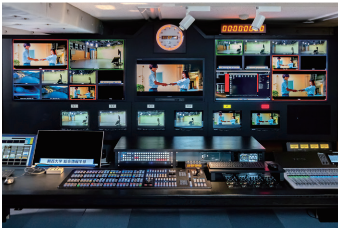
▲スイッチャー卓の中央にKAIROSのコントロールパネルを配置し、モニター棚には自由なレイアウトにカスタマイズできるマルチビューワーを2面装備
