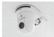
▲ 801講義室に設置されたAW-UE40W。赤外線ワイヤレスリモコンAW-RM50AGを用いてアングルの切り替えを行う
