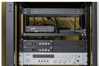
▲ 講義室の機器ラック。WU-L61の主電源ボタンを押すだけで全ての機器が起動するため授業の準備がスムーズになったと好評
