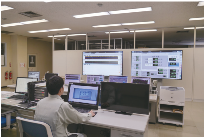
▲ i-PRO Remo. サービスを活用して、計装盤を天神浄化センターの中央操作室から監視
