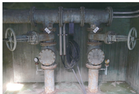
▶ 稼働状況を監視しているポンプ
