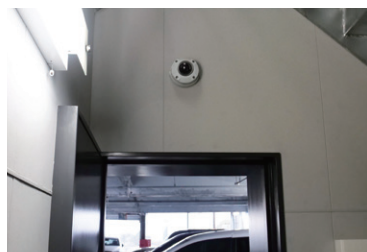
◀ 歩行者通路に屋外ドームカメラを設置し、駐車場の隅々を監視可能
