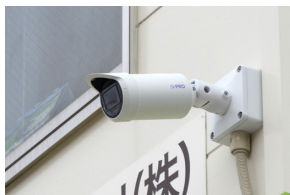
▲ 店舗に設置された屋外ハウジング一体型カメラは給油レーンを撮影
