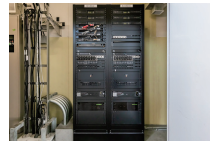
▲ バックスタンドアンプ室の電力増幅架。WP-DM912が格納されている
