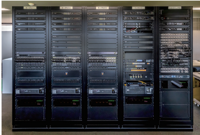
▲ オペレーション室に設置された電力増幅架と周辺機器架。デジタルパワーアンプWP-DM948/912とオーディオインターフェースユニットWR-SB350が格納されている
