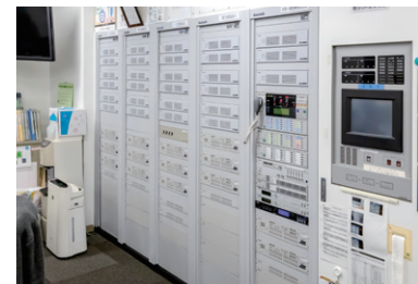
◀管理事務室に設置されたラック形非常用放送設備WL-8500A
