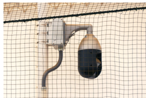
▲ 屋根付き広場内に設置されたPTZカメラ
