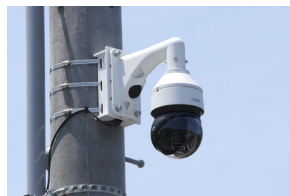
▲ アーバンスポーツパーク駐車場に設置された屋外PTZカメラ
