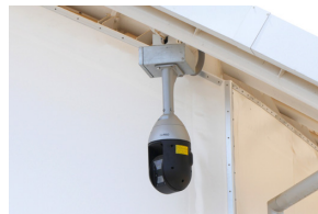
▲ みなくる広場駐輪場に設置された屋外PTZカメラ
