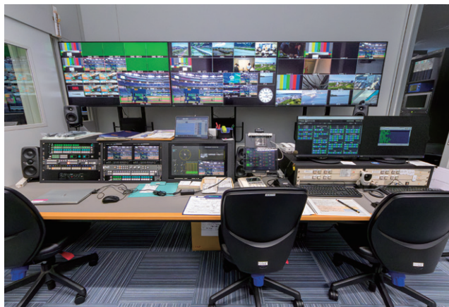
▲ 回線室の様子。中央右手にはブロードキャストコントローラーの監視端末「PSS」を配備
