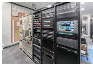
▲ ラック室に設置された回線ラック
