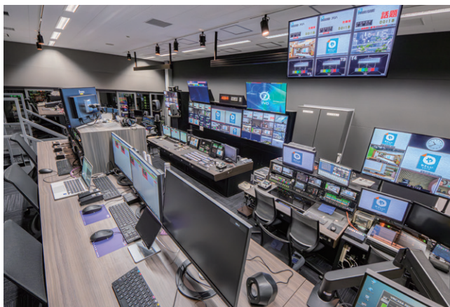
▲ 中二階のある1サブでは、1階中央にKAIROS、中二階に送出サーバーのOA端末を設置
