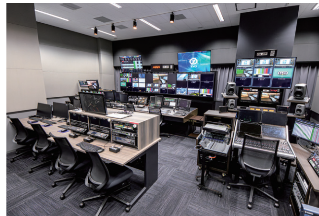
▲ 収録サブや受けサブとして使用される2サブ。1サブと同様にKAIROS(AT-KC1000T)を導入
