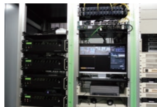
▲ サーバー室に設置されたAI画像解析システム
