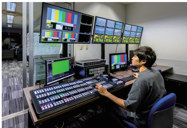
▲ Dサブ内につくられた第二サブにはKAIROS(AT-KC1000T)を導入
