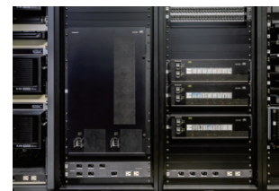
▲ AV-HS8300メインフレーム(ラック左)とIPゲートウェイ(ラック右)
