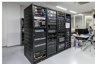
▲ 左:報道サブの映像ラック。中央・右:2023年に納入したファイルベースとアーカイブシステムのラック
