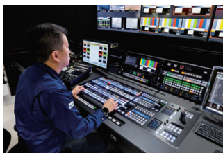
▲ 制作サブのKAIROSコントロールパネル
