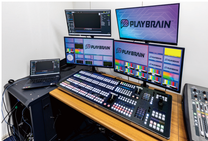
▲ KAIROS操作卓の様子。コントロールパネルの正面には2面のマルチビュー画面を配置。左手にはすぐに操作できるようKairos Creator用のPCが置かれている
