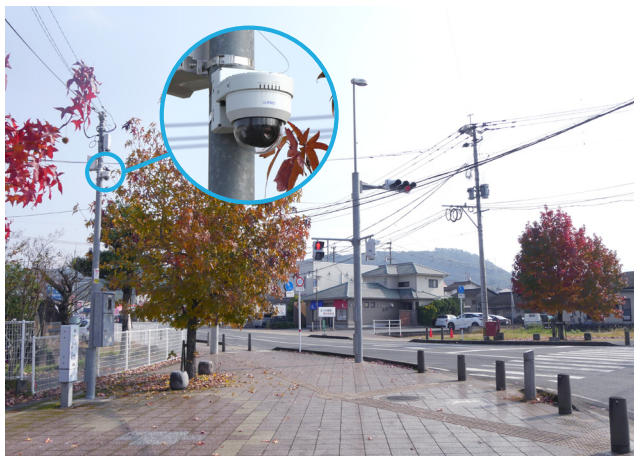
▲ 屋外PTZカメラはLTE無線通信ユニットと合わせ、町内の主要交差点5カ所に設置
