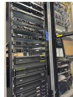
▲サーバーラック
