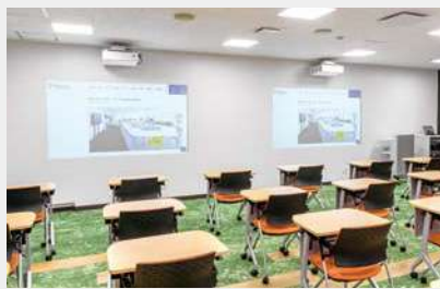
約 30 名の収容が可能な 106 教室。マイクとして WX-AM800、映像表示機器として PT-CMZ50JW と TH-65EQ2J を導入
