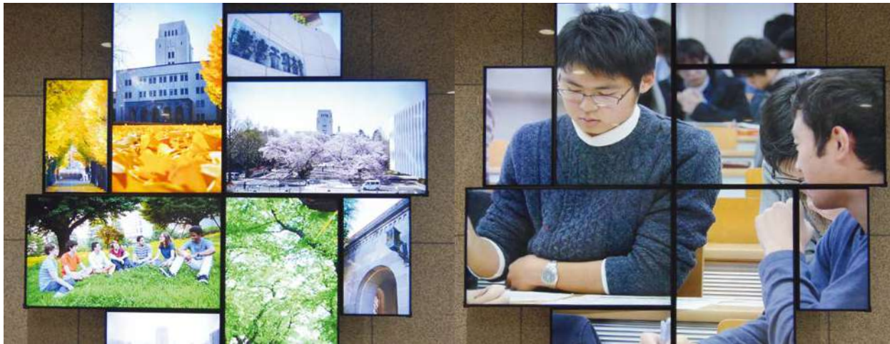
▲ 導入事例 東京工業大学様 デジタルサイネージシステム 施設のロビーに設置されたマルチディスプレイ。「AcroSign®」を採用することで、別棟にある管理事務室からマルチディスプレイで放映するコンテンツを効率的に管理。
