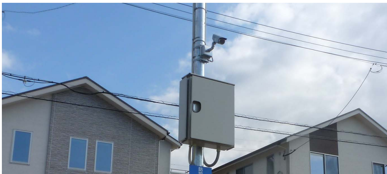
設置された監視カメラ
