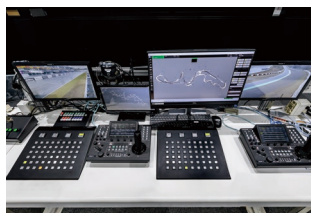
▲ 東管制室の制御卓
