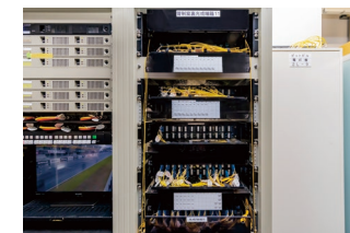
▲ カメラ映像を東管制室内に伝送している光回線
