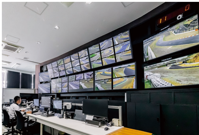
▲ コースのモニタリングを行う東管制室。カメラ映像は10面のモニターに表示されており、内6面をMVで運用
