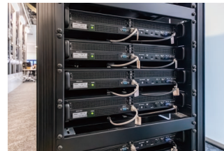
▲ ラックにはコントロールボックスをまとめて格納
