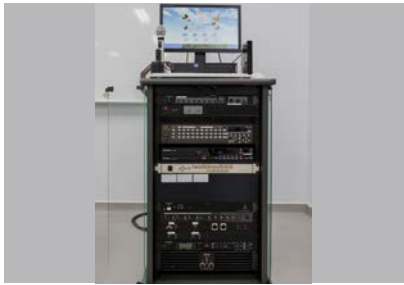
前面ボタンで映像切り替えが行えるデジタルマルチスイッチャーを装備した映像・音響ラック
