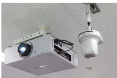
天井面に設置されたHDカメラとプロジェクター
