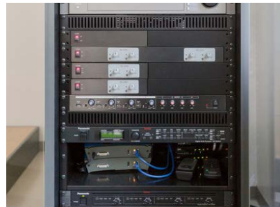
各種映像・音響機器ラック
