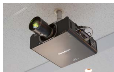
天井に設置されたプロジェクター
