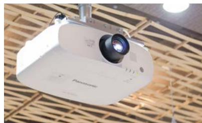
天井に設置されたプロジェクター
