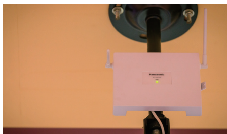
ホール内に設置されたアンテナステーション WX-CR200
