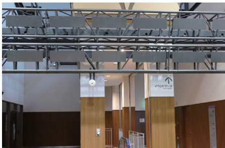
館内に設置された全方位ネットワークカメラ
