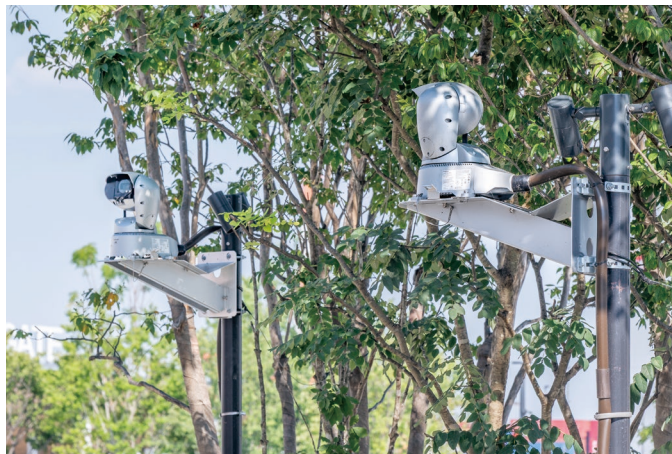
▲ 幕を撮影する2台の屋外リモートカメラAW-UR100GJ。空間に溶け込む外装デザインも好評
