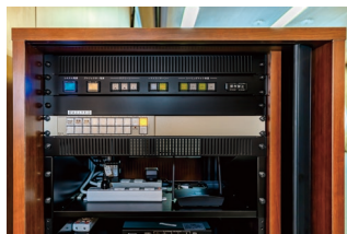
▲ 会議室内の機器ラック。操作パネルの電源を入れるだけでシステムを運用可能
