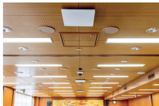
▲ 3台のWX-AM800は会議室天井の中心に1列に並べて設置
