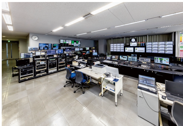
▲ 報道フロアの横に配置されているNサブ全景。NサブもマルチビューはKAIRO5を活用
