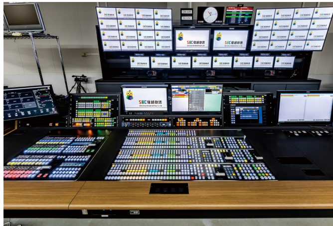
▲Sサブのスイッチャー卓。中央にIPスイッチャーAV-HS8300の操作パネルを設置。モニターはKAIROSのマルチビュー機能を使用しており、回線設備やNサブの映像も直接アサインすることが可能
