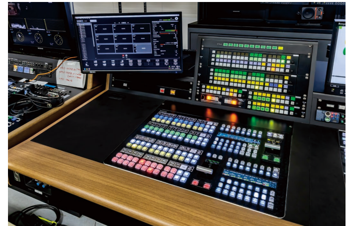
▲AV-HS8300操作パネルの左側にはKAIROSのコントロールパネルを設置。AV-HS8300の入力ソースの1つにKAIROSのプログラムアウトを入れており、KAIROSで作成した素材をAV-HS8300で扱うことが可能
